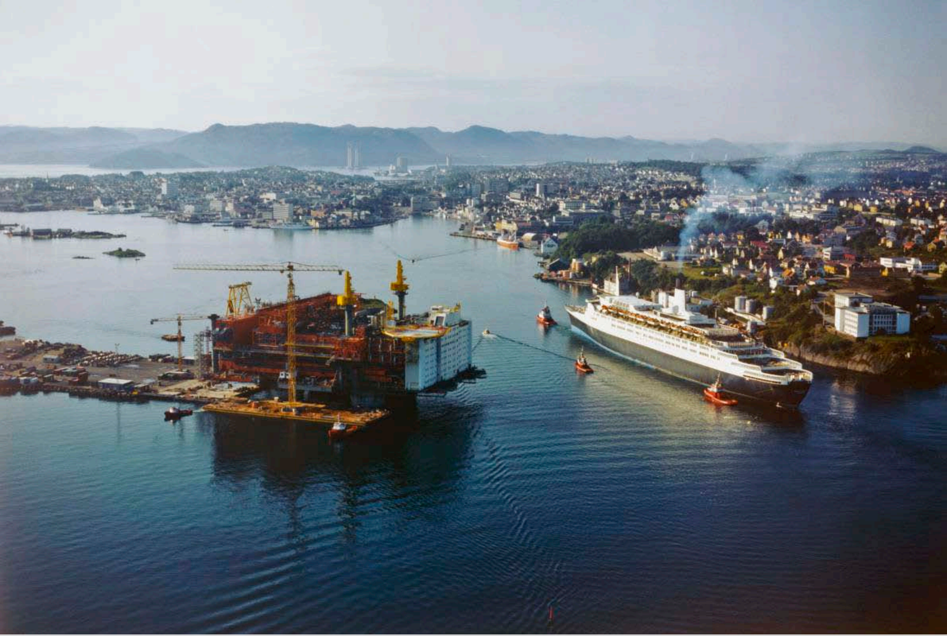
Statfjord B-dekket under bygging ved Moss Rosenberg Verft i Stavanger. Bilde: Leif Berge
